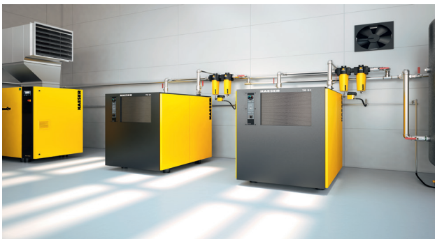
Bestandsaufnahme der Anlage direkt beim Kunden
