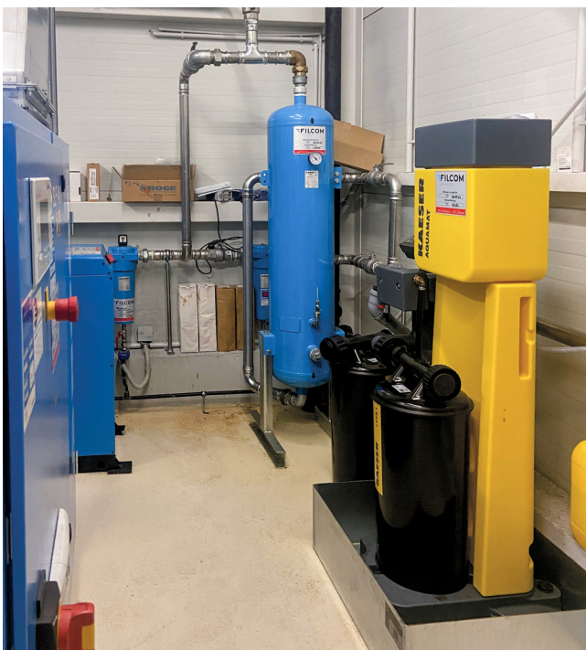
Blick auf die Druckluftstation bei alphacam Bildquelle: alphacam GmbH
